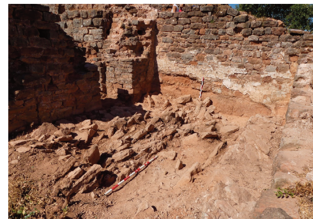
Detall de la coberta caiguda amb les pedres en sardinell
